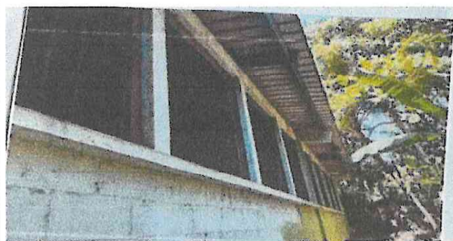
Foto 3: POPINTURA EN MUROS INTERIORES Y EXTERIORES, DETERIORADA Y EN MAL ESTADO
